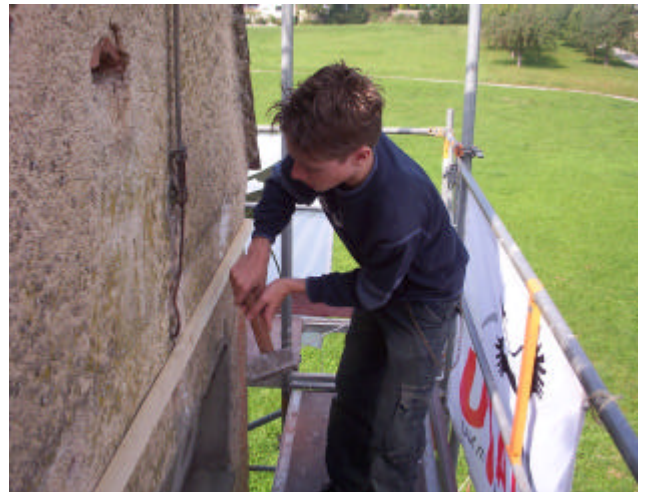
Zusätzlich zu den vorhandenen Schleiereulen-Quartieren wurde eine Holzverkleidung für Fledermäuse von den Kindern und Jugendlichen der Naturschutzjugend Aspach angebracht.
